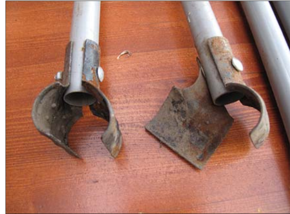
Abbildung 4: Rost und die Auswirkungen bei Torsion.
